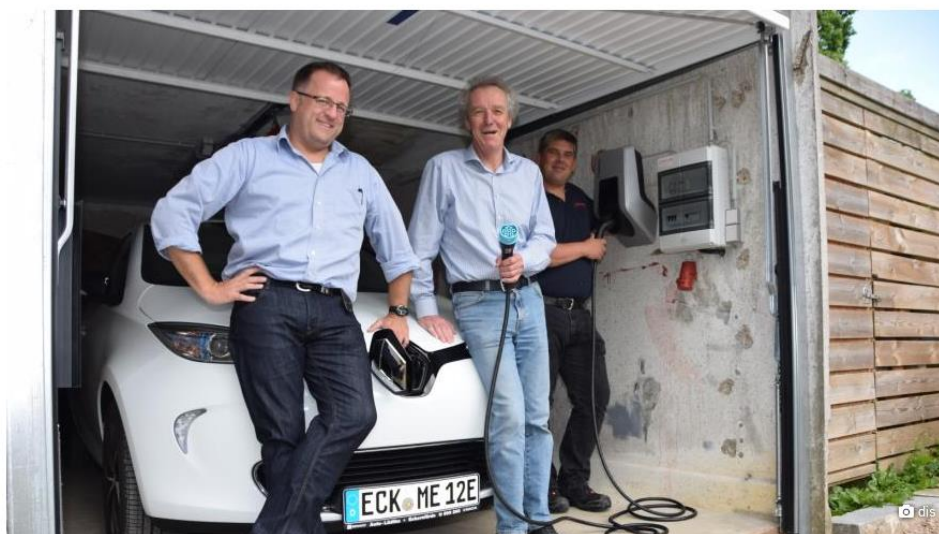
Pastor Martin Krumbeck (Mitte) kann nun in der heimischen Garage tanken. Elektroinstallateur Sebastian Haupt von der Firma Petersen Haustechnik baute die Stromladestation ein. Tobias Lehmann (l.) von Renault Auto-Lüdtke lieferte den Strom-Pkw Zoe.
